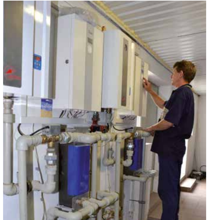
6 Kotłownia z panelami sterowania powietrznych pomp ciepła DHP-AQ.
